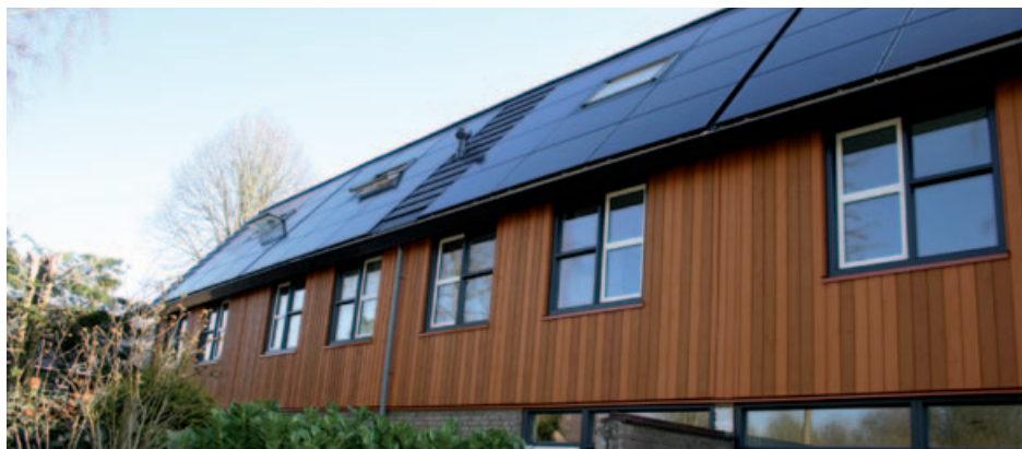
Op het dak werden per woning 11 indak pv-panelen aangebracht. (foto's: SPF Beheer)
