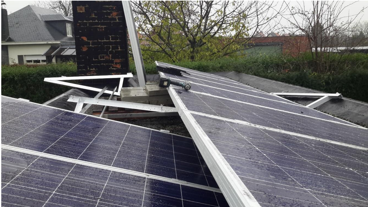
Panelen over elkaar gelegd met inferieur constructiemateriaal
