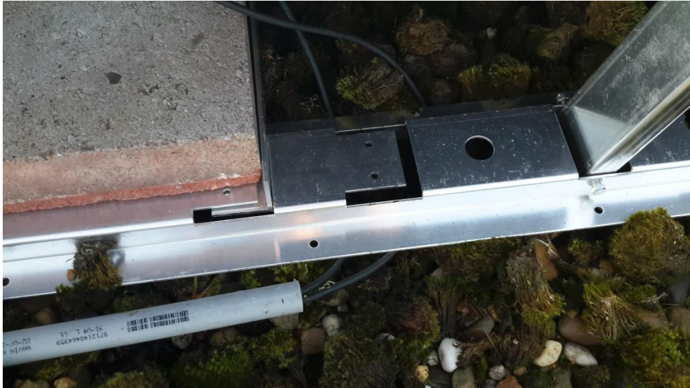
Kabels tussen constructie door, kans op insnijden
