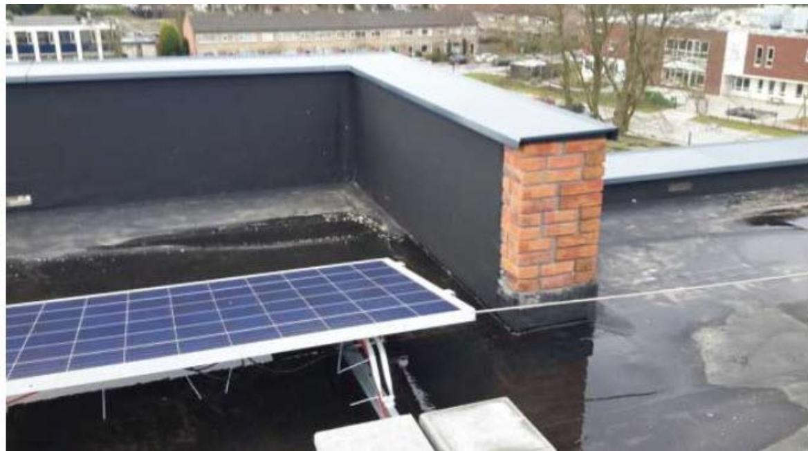
Paneel in schaduw en over valbeveiligingslijn heen
