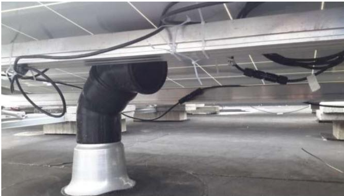
Paneel te strak tegen afvoer aan
