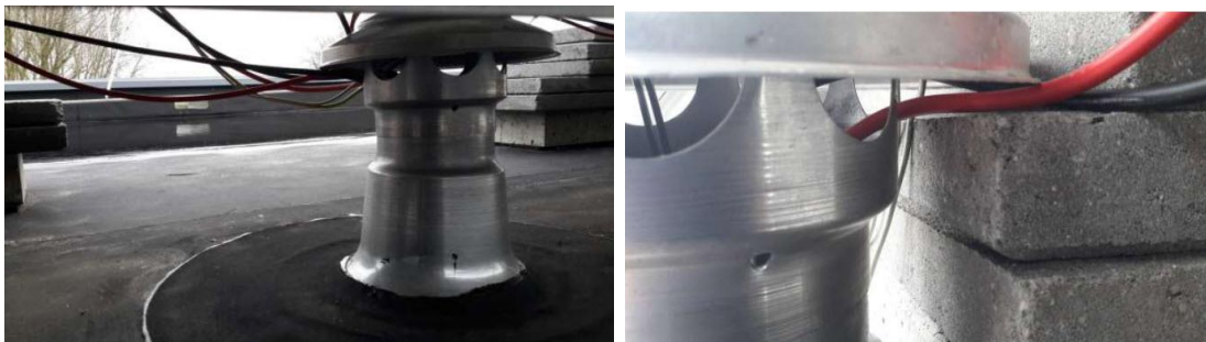
Kabels loshangend, niet beschermd tegen insnijden
